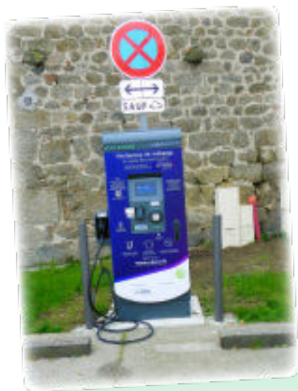
La borne électrique
